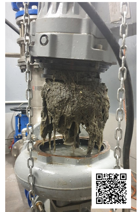
Pompe bouchée / Verstopfte Pumpe
