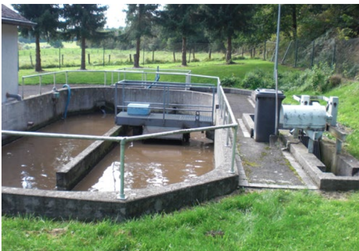
Rechenanlage und biologische Behandlungsstufe
