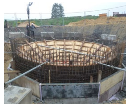
Schlammstapelbehälter KA Trotten
