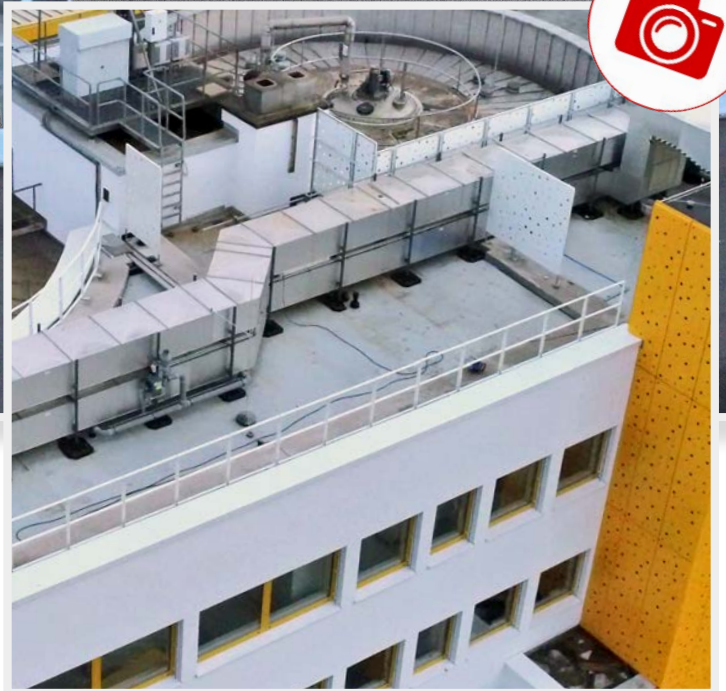
Système de ventilation du 2ème étage
