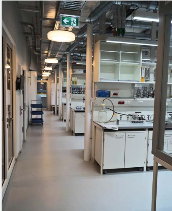
Postes de travail séparés en fonction des analyses réalisées
