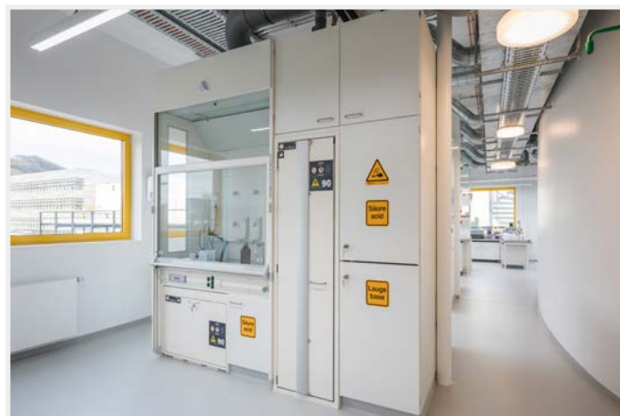
● Vue sur la hotte chimique au second étage du laboratoire ouvert
