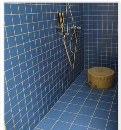
Douche pour le nettoyage des échantillonneurs
