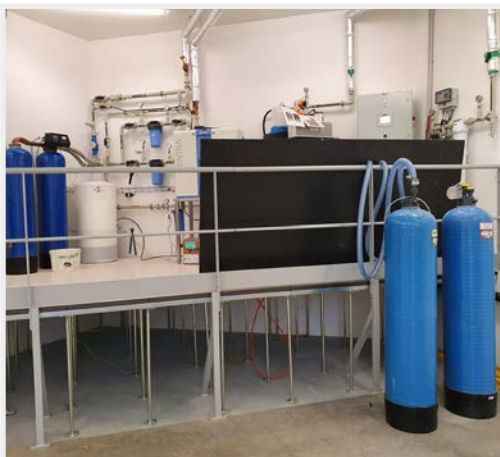
Installation complète pour la production d'eau déminéralisée
