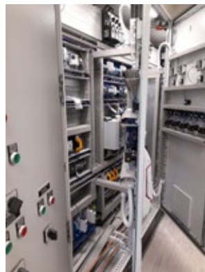
Elektroschrank im Schalraum
