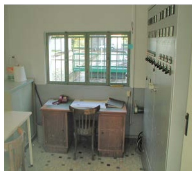
Vue intérieure de la maisonnette avec armoire électrique
