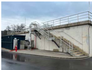
Silos à boues et biofiltre
