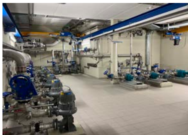
Salle de pompes - biologie et boues
