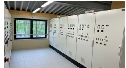
Salle de commande et des armoires électriques
