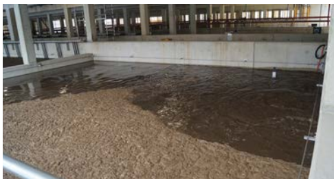
Biologie 1 en service / 1. Biologie in Betrieb
