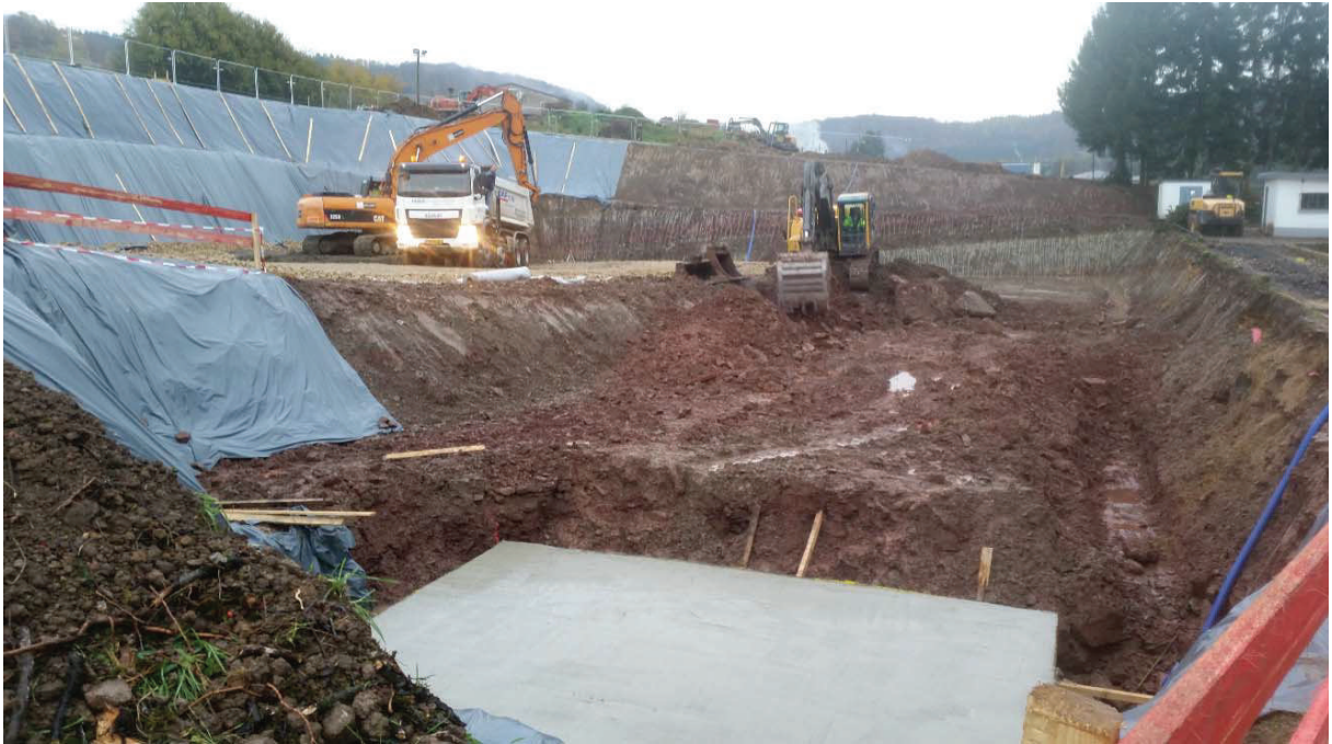
Photo: Travaux de terrassement de la voie de traitement biologique à Medernach - Phase I
