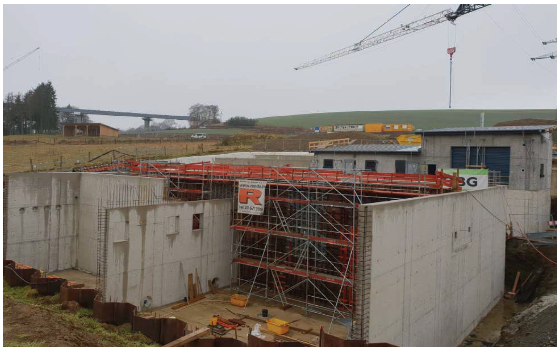
Photo: Station d'épuration à Urspelt - Voie de traitement biologique et bâtiment technique en cours de réalisation
