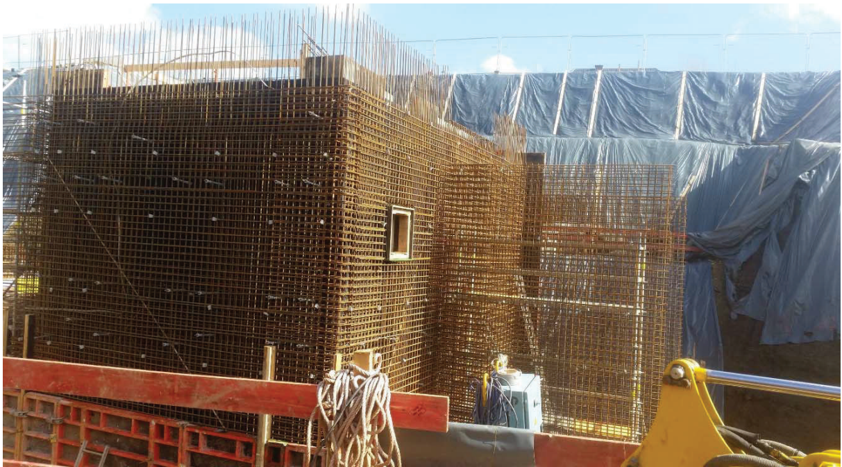
Photo: Ferrailage de la fosse d'entrée de la future station d'épuration de Medernach
