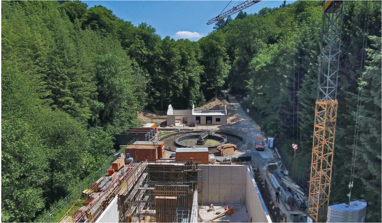
Photo: Future voie de traitement biologique, bassin combiné en service et bâtiment technique de la station d'épuration de Consdorf
