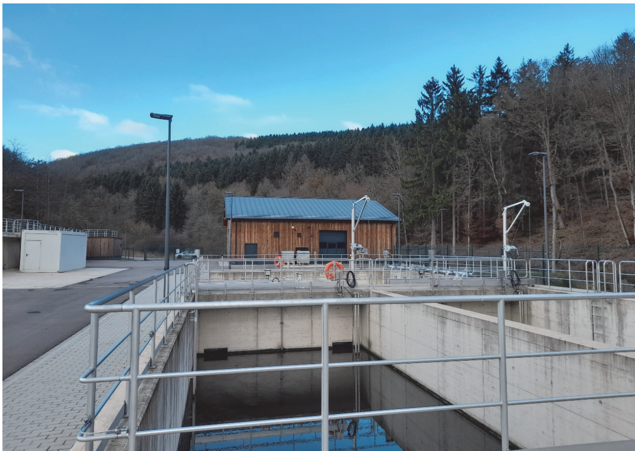
Photo: Station d'épuration à Folschette 2.500 EH – Bâtiment de prétraitement / bassin biologique en marche semi-industrielle
