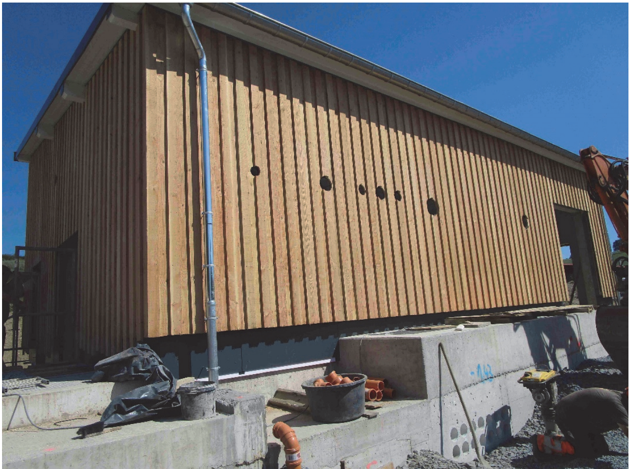
Photo: Station d'épuration de Leithum 250 EH - Bâtiment technique en cours de réalisation
