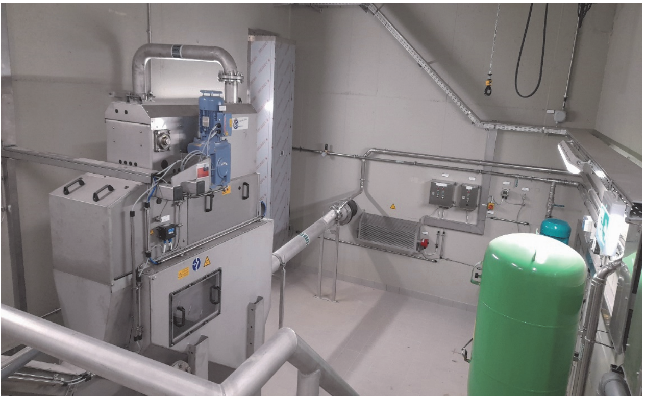
Photos: Station d'épuration à Dellen 250 EH – Bâtiment de prétraitement et dégrilleur fin
