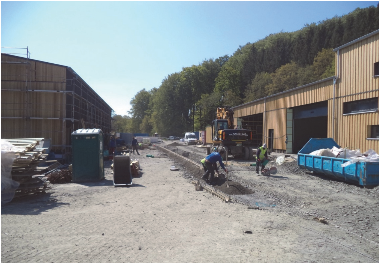
Photos: Station d'épuration à Troisvierges 8.400 EH - Bâtiment technique en cours de réalisation
