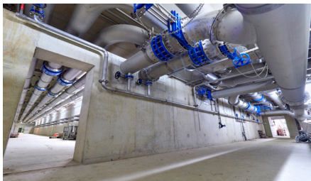
Diverses conduites d'approvisionnement en cave / Verschiedene Rohrleitungen im Kellergeschoss
