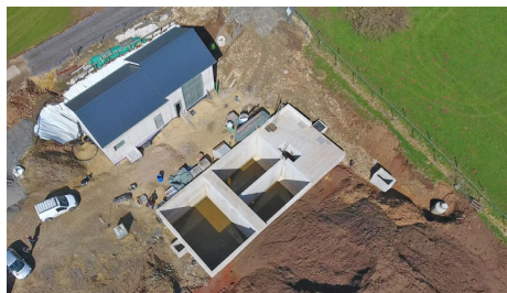
Vue aérienne STEP Buschrodt / Luftbild KA Buschrodt
