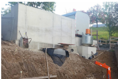
Bassin d'orage / Regenüberlaufbecken
