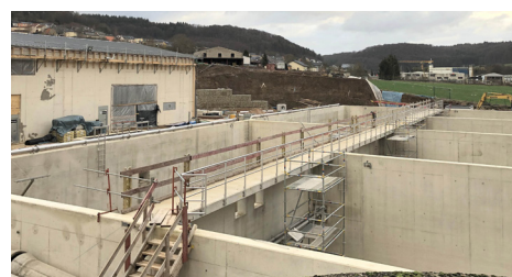
Vue sur les bassins biologiques à Medernach / Blick auf die biologischen Becken in Medernach
