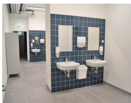
Installations sanitaires / Sanitäranlagen
