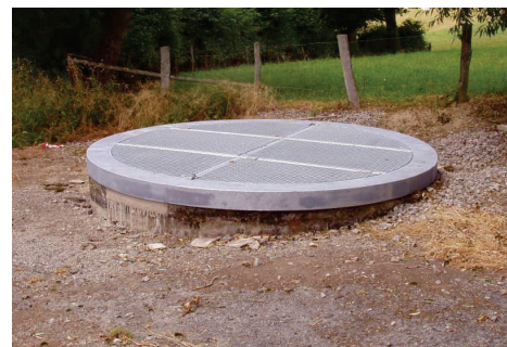
Bestehende mechanische Kläranlage
