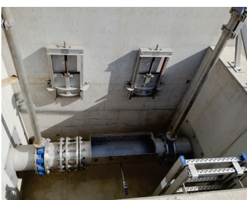
Ablaufschacht Biocos® -Becken
