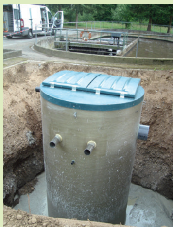
Provisorisches Pumpwerk «Alte Kläranlage»
