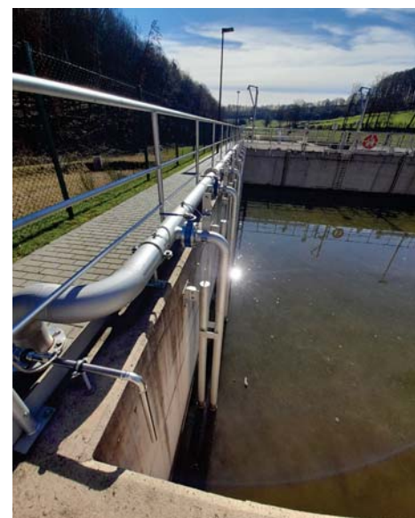
Vue sur le bassin d'activation
