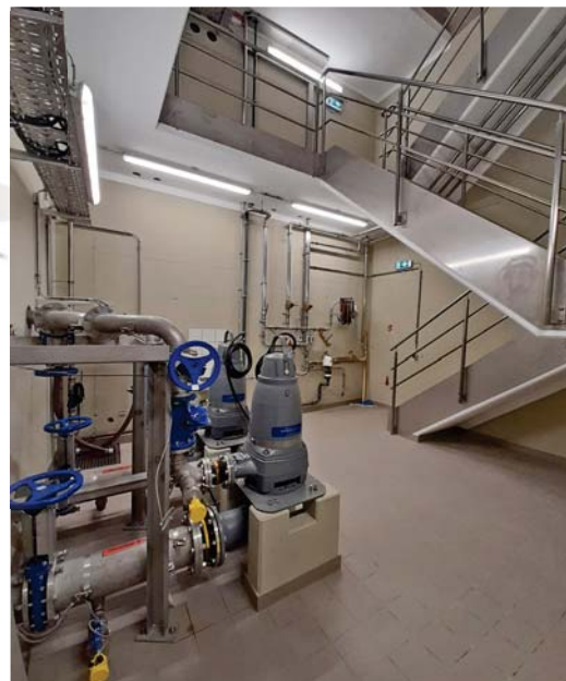
Vue sur les pompes
