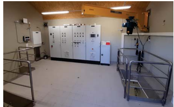
Vue sur les armoires électriques
