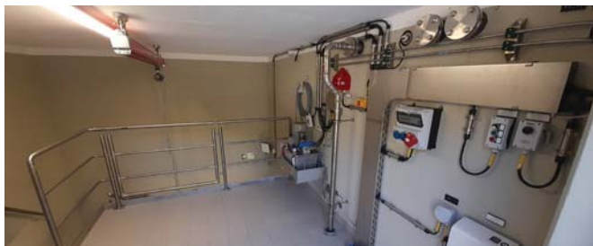
Vue sur le débitmètre
