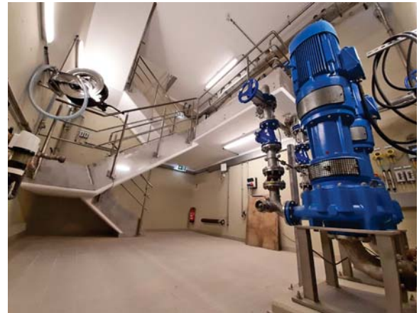
Vue sur les pompes
