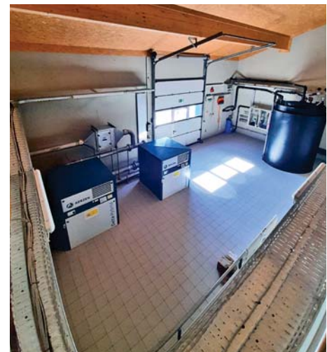
Vue sur les surpresseurs et l'installation de précipitation des phosphates
