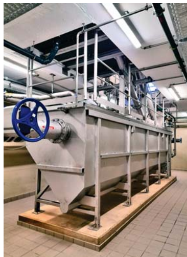
Vue sur la station de prétraitement
