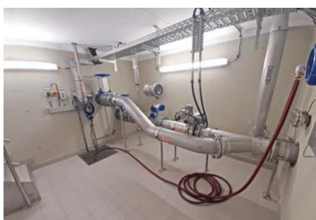
Vue du local technique
