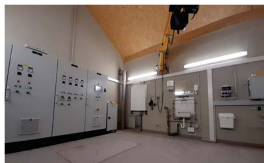
Vue sur les armoires électriques
