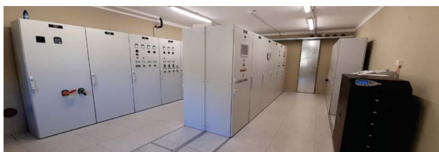
Vue sur les armoires électriques
