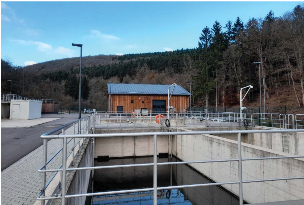
Photo : Station d'épuration à Folschette 2.500 EH – Bâtiment de prétraitement / bassin biologique en marche semi-industrielle
