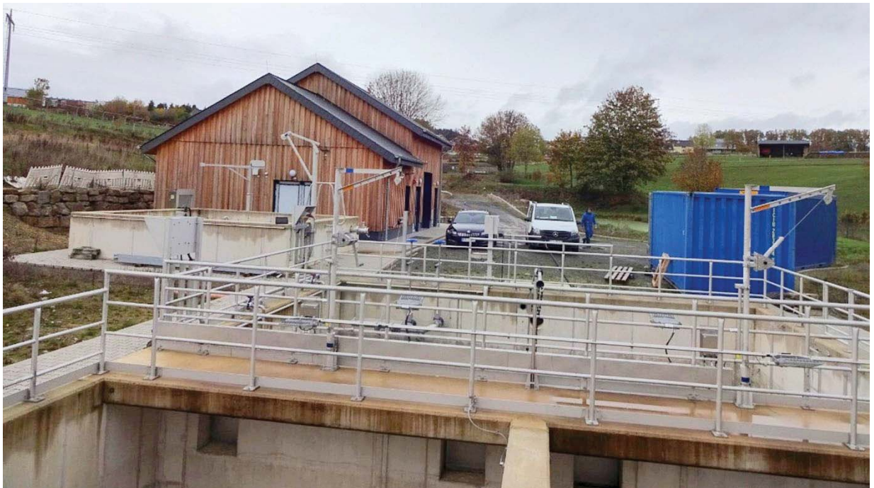
Photo : Station d'épuration à Hoscheid-Dickt 700 EH – Bassin biologique avec bâtiment technique en arrière-plan.
