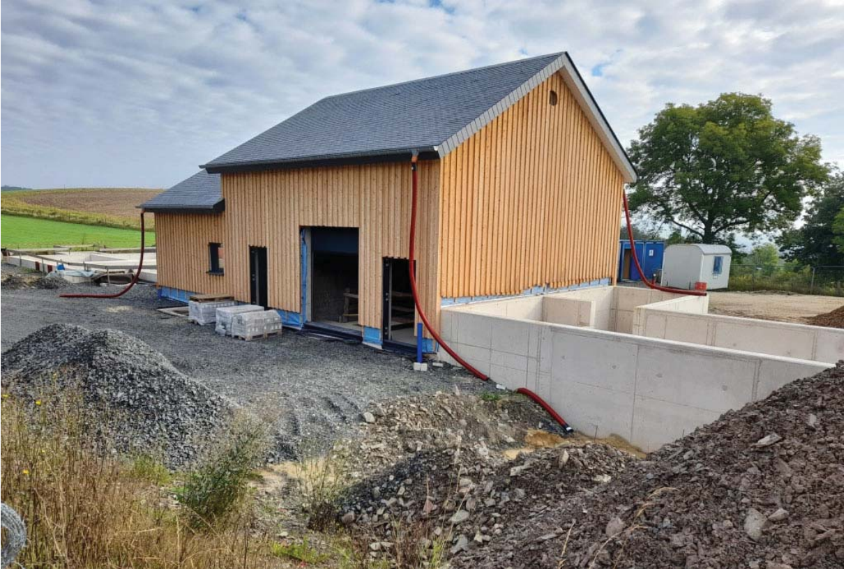
Photo : Station d'épuration à Putscheid 650 EH – Bâtiment de prétraitement et bassin d'orage en cours de réalisation
