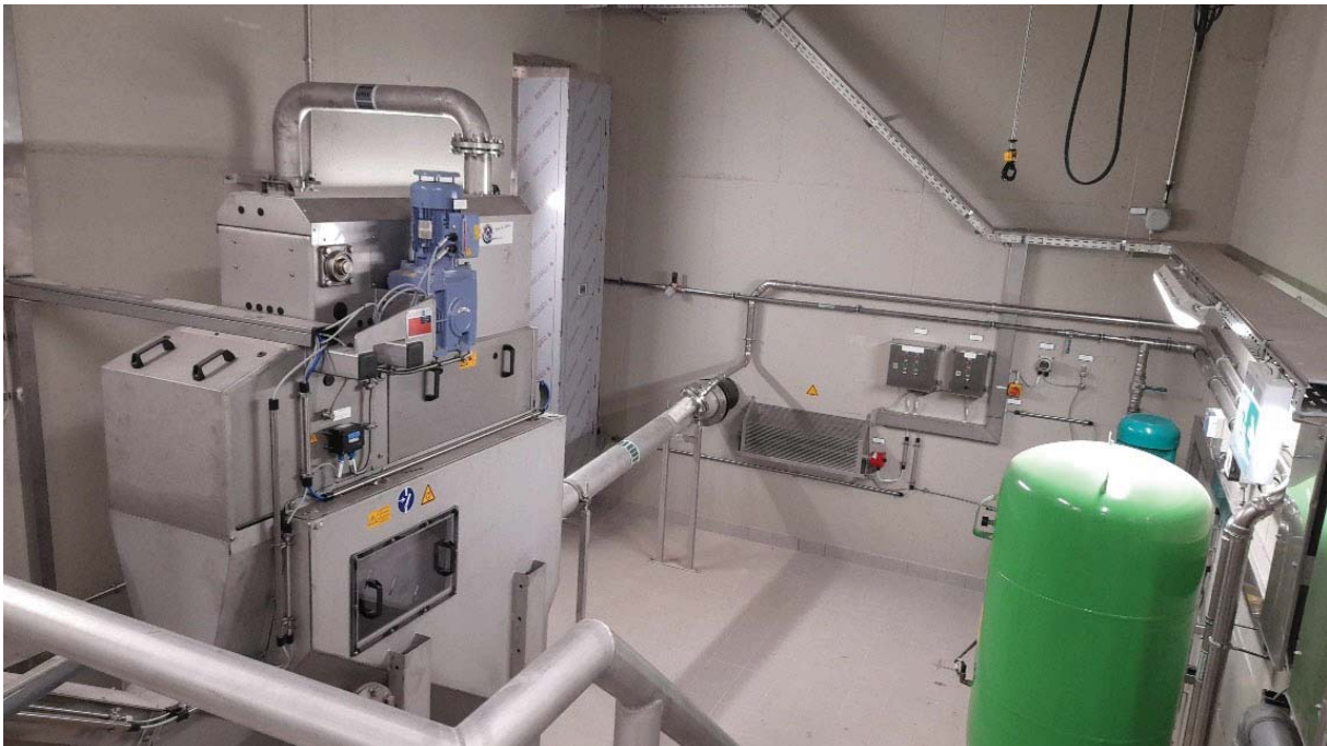
Photos : Station d'épuration à Dellen 450 EH – Bâtiment de prétraitement et dégrilleur fin
