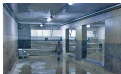
Vue dans un bassin d'orage fermé (Diekirch)
