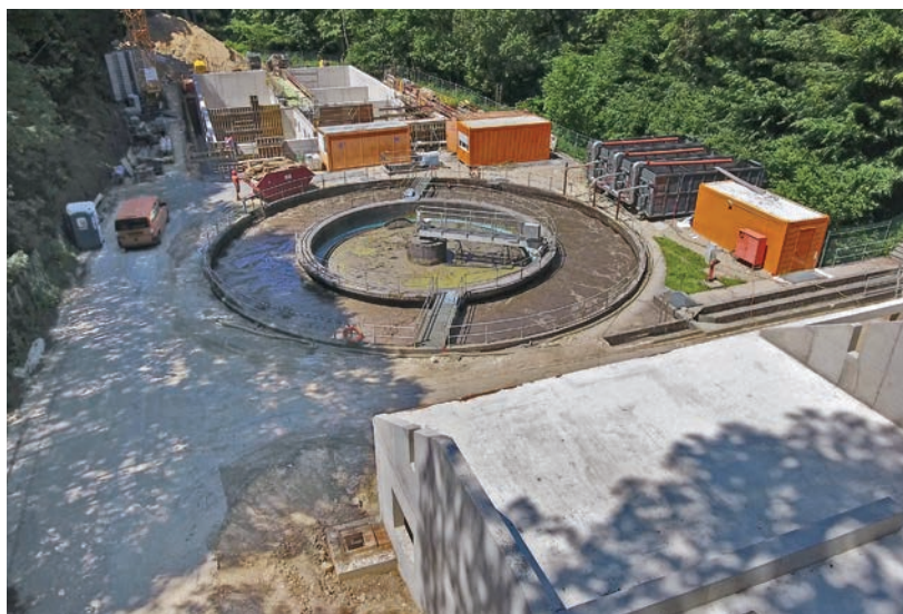
Vue du bassin biologique combiné en service de la station actuelle.
