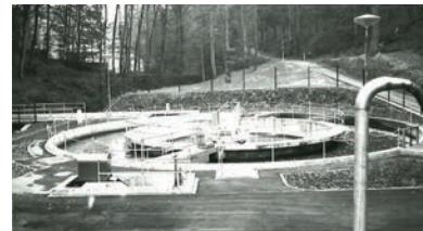
Mise en service de la station de Consdorf en 1979
