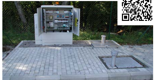
Vue extérieure sur l'armoire électrique des commandes
