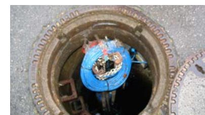
Regard de la station de pompage « Dielchen »
