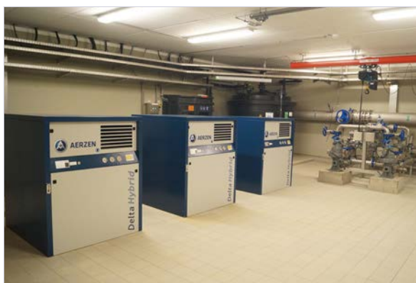
Vue sur les surpresseurs et l'installation de précipitation des phosphates
