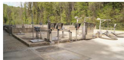
Vue sur les silos à boues et des commandes pour les vidangeuses
