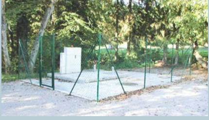
Bassin d'orage et station de pompage Juckefeld 30 m 3
