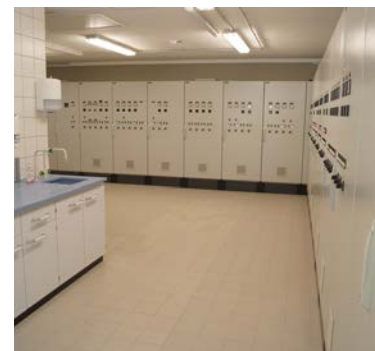
Vue sur les armoires électriques
