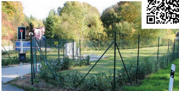
Vue extérieure sur le bassin d'orage avec station de pompage de Scheidgen
