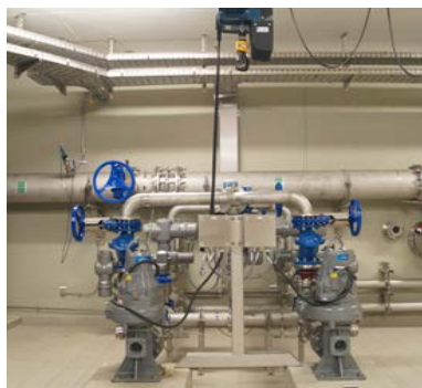
Vue sur la station de pompage des boues en excès
