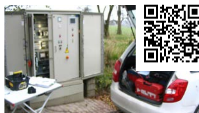
Armoires électriques hébergeant les commandes
