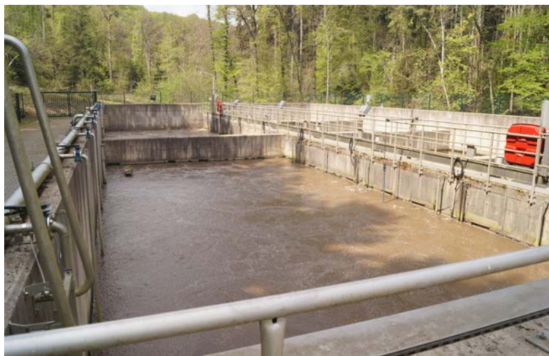
Vue sur le bassin d'activation
