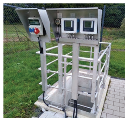
Vue sur la sortie des eaux épurées
