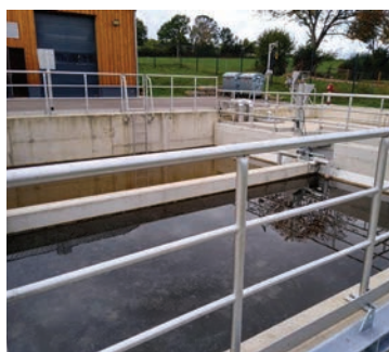
Une des voies de traitement biologique
