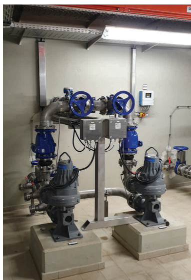
Station de pompage des boues en excès
