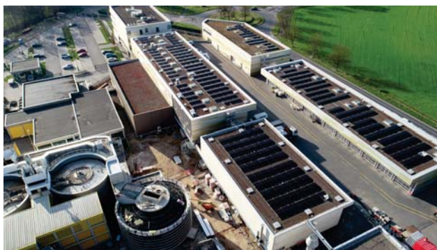
Installation photovoltaïque opérationnelle / Photovoltaikanlage in Betrieb
