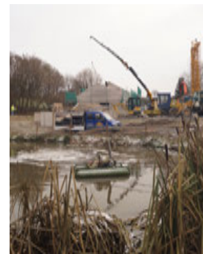
Belüftete Teichanlage (alt)
