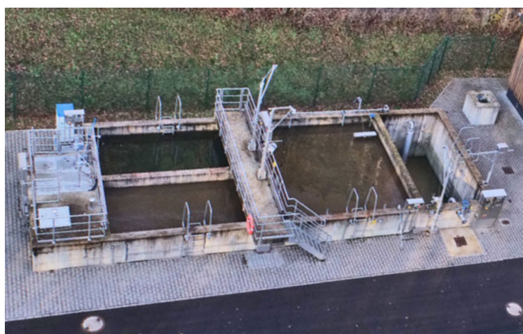
Biologische Reinigung KA Rodershausen
