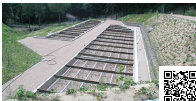
Bepflanzter Bodenfilter (vor Erstinbetriebnahme)
