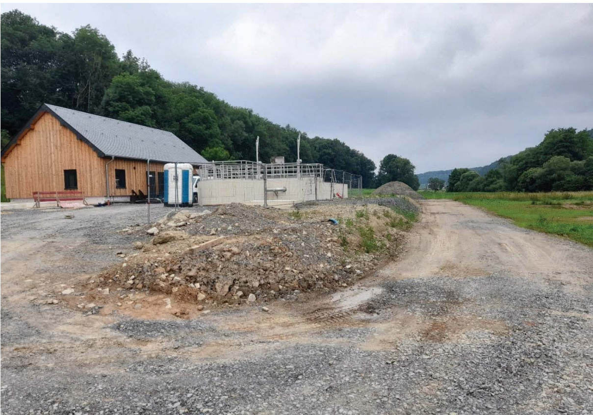
Photo: Station d'épuration à Hoesdorf 300 EH – vue d'ensemble sur bâtiment technique et bassin biologique
