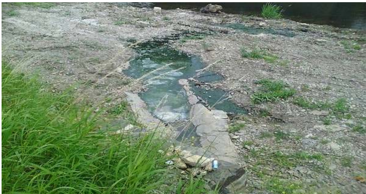
Photo: Rejet d'eau usée dans le milieu naturel à Ingeldorf suite à une erreur de branchement
