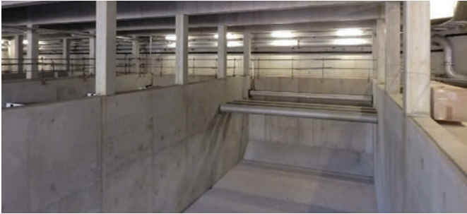
Sortie bassin de décantation secondaire / Auslauf Nachklärbecken
