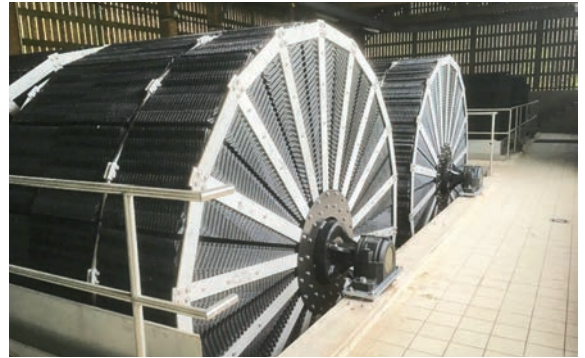
Voie biologique nouvellement équipée / Neu ausgerüstete Biologie
