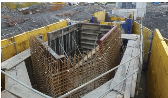
Bassin d'orage à Crendal / Regenüberlaufbecken in Crendal
