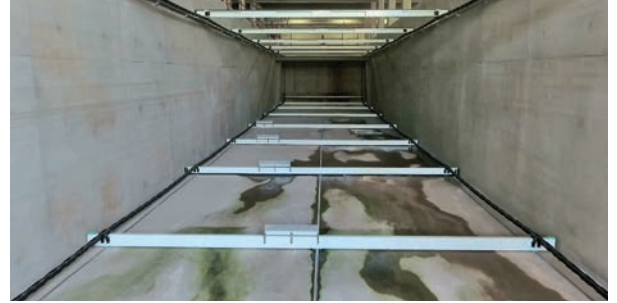
Racleurs dans le bassin de décantation secondaire / Räumschilde im Nachklärbecken
