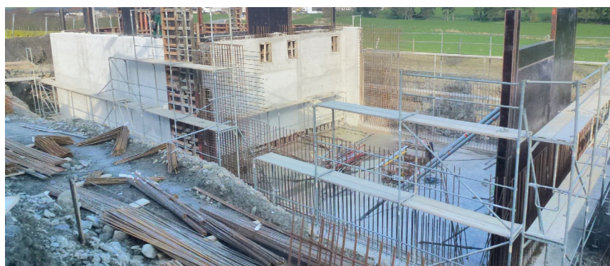
Biologische Reinigung KA Troine
