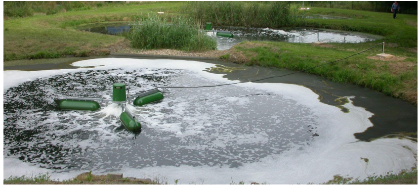
Oberflächenbelüfter am Beispiel der Kläranlage Putscheid
