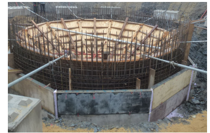
Schlammstapelbehälter KA Troine
