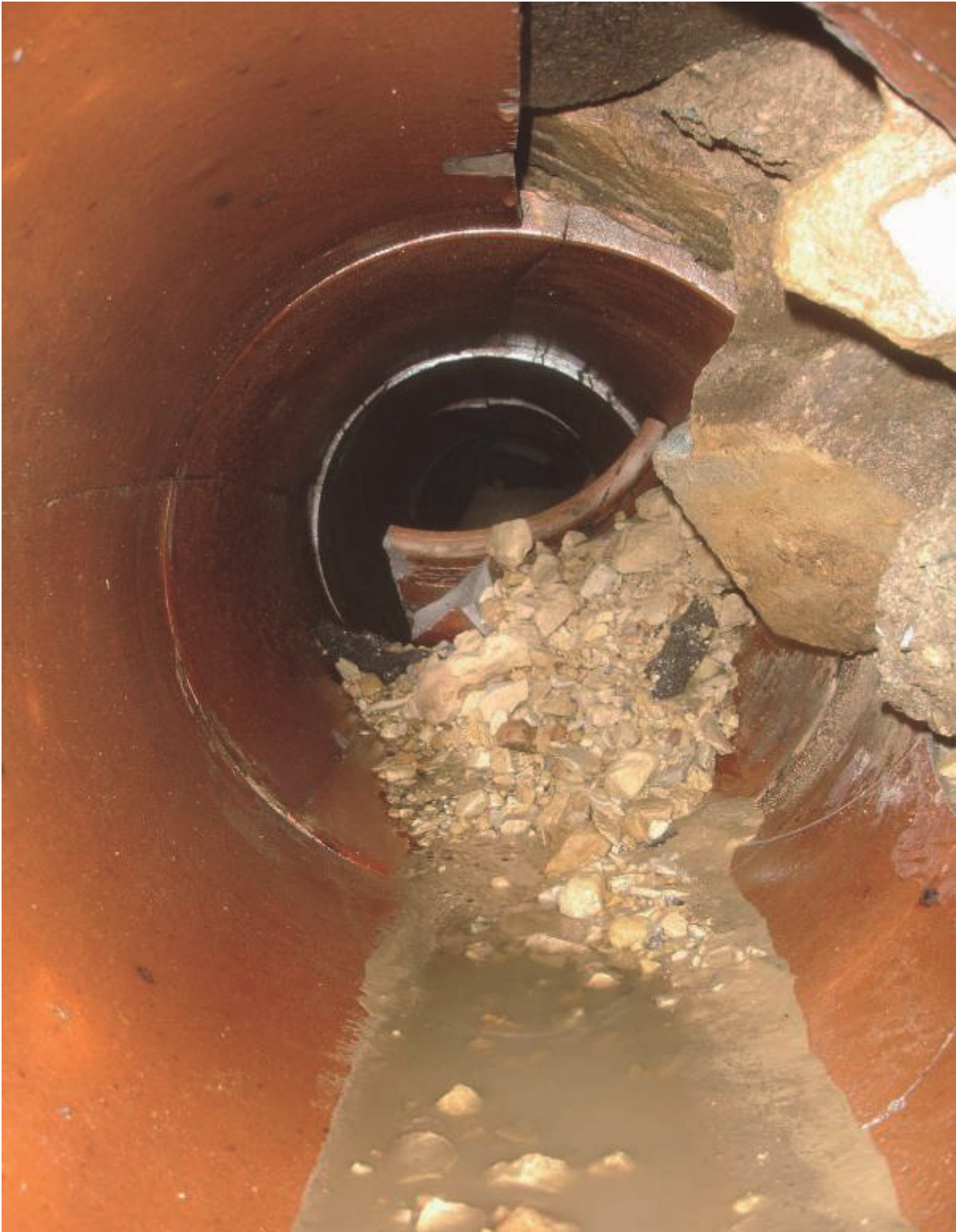
Photo: Vue télévisée d'un effondrement de canalisation à Larochette
