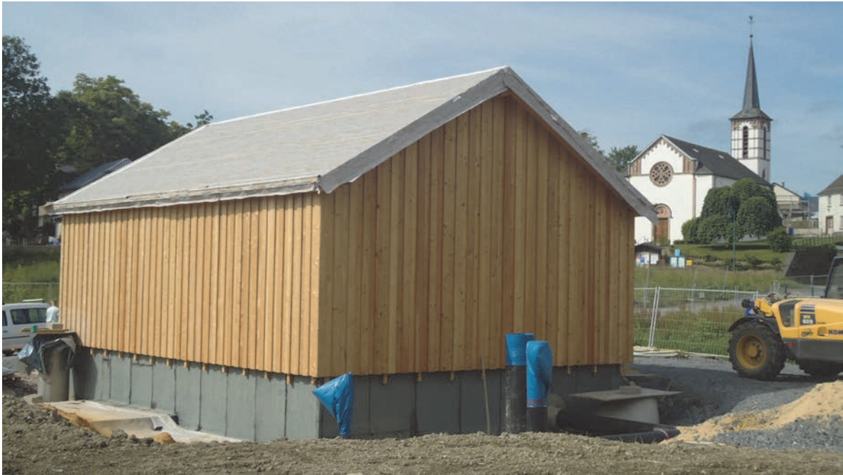
Photo: Station d'épuration à Baschleiden
