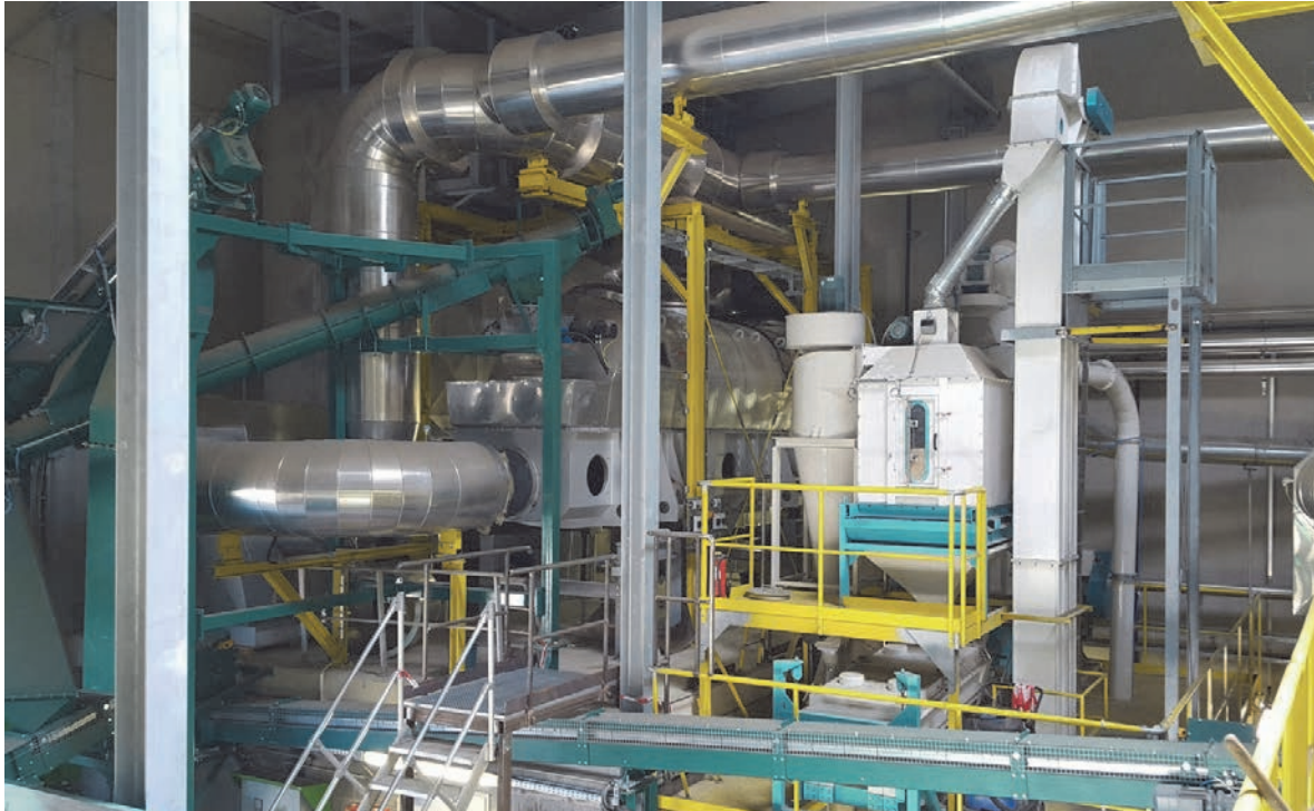
Fig 4 : Vue sur l'unité de granulation (au milieu) et le sécheur vibrant à lit fluidisé (à gauche).
