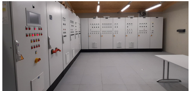
Vue sur les armoires électriques
