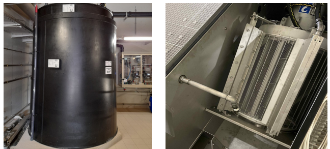
Cuve de précipitants Dégrilleur fin
