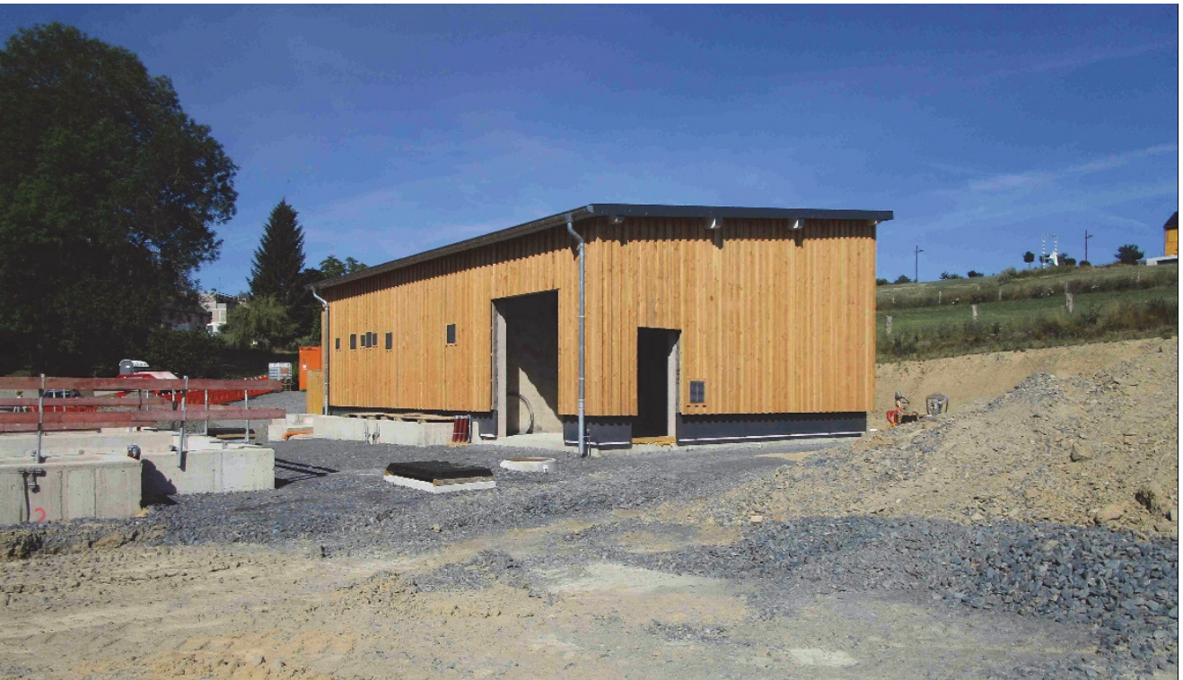
Photos: Station d'épuration à Leithum 350 EH - Voie de traitement biologique et bâtiment technique en cours de réalisation
