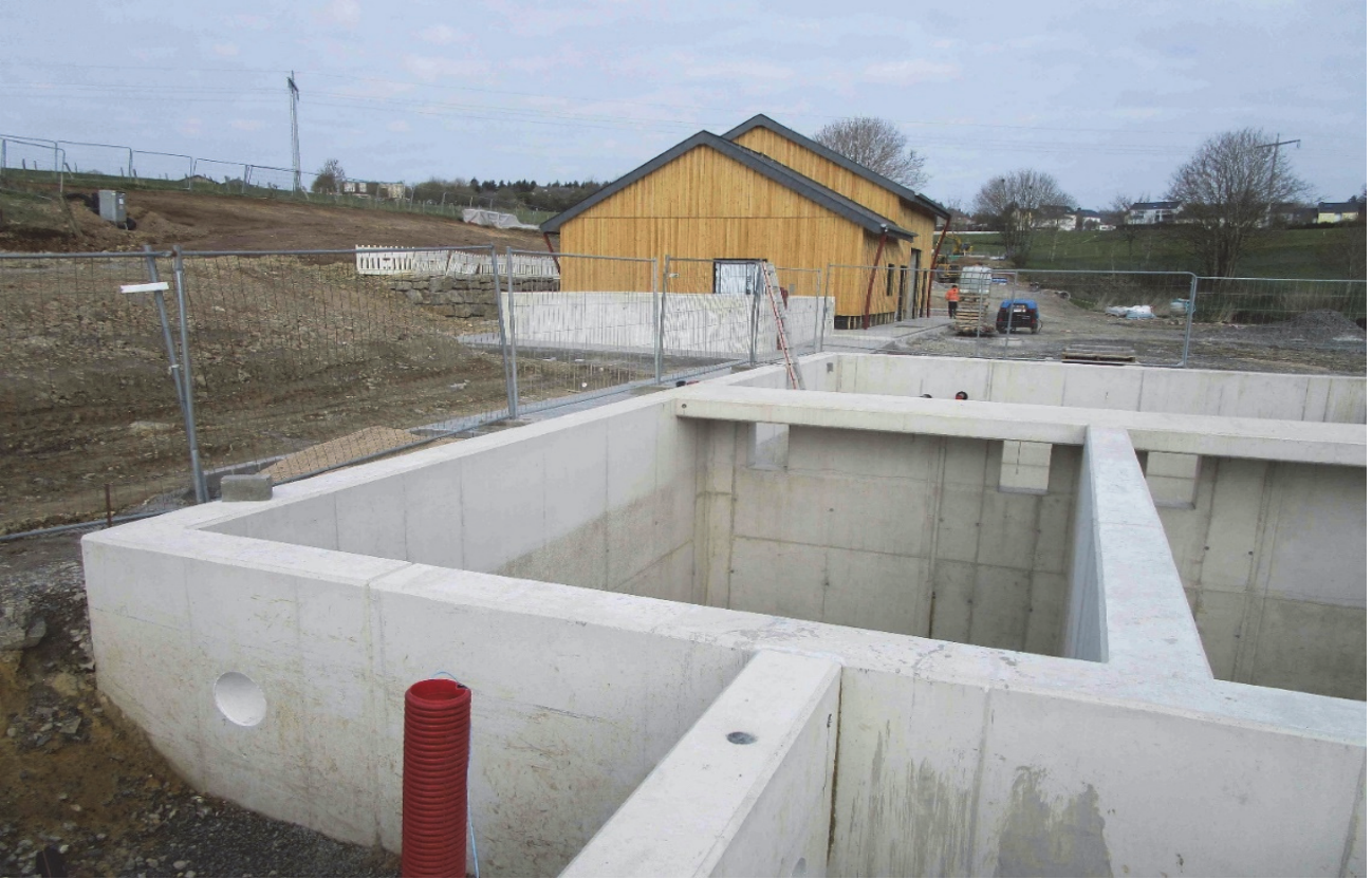
Photo: bassin de traitement par voie biologique au premier plan et bâtiment technique au second plan de la station d'épuration de Hoscheid-Dickt – 700 EH
