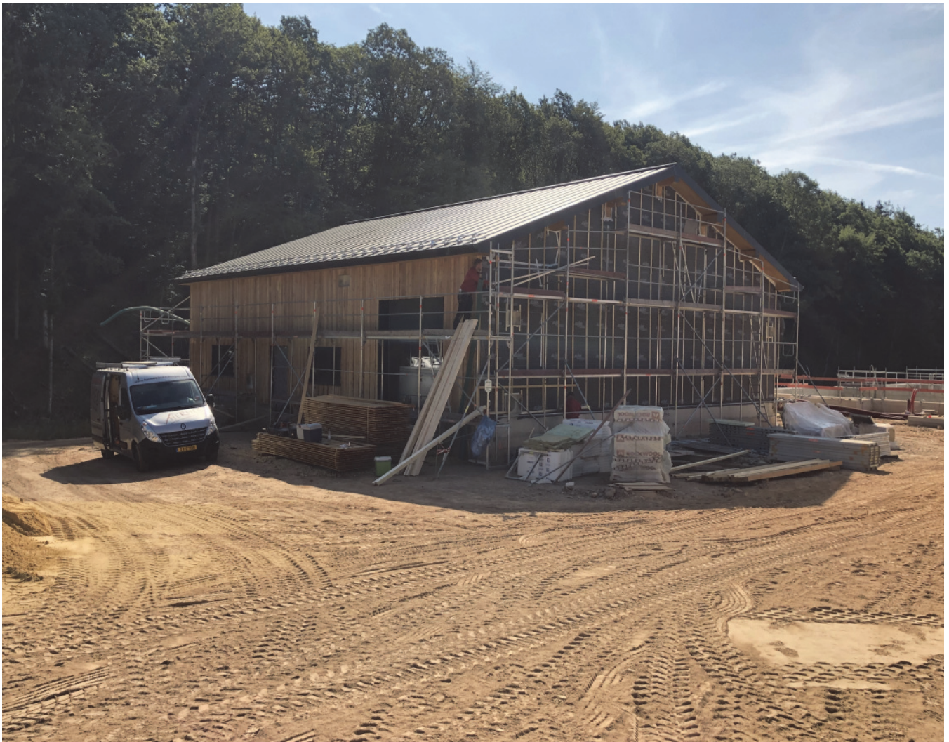
Photo: Station d'épuration à Folschette 2.500 EH – Bâtiment de prétraitement – travaux de bardage en cours de réalisation
