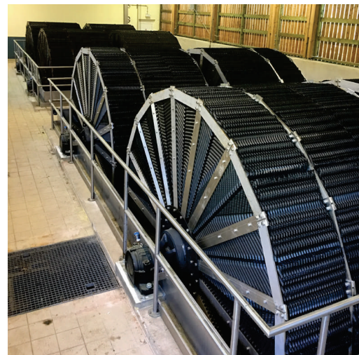
Gesamtübersicht der sanierten biologischen Stufe
