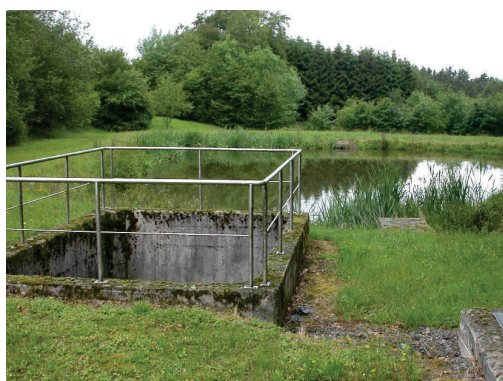
Bestehende Anlage - 2-Kammer Absetzgrube zur mechanischen Vorreinigung
