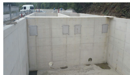
Kläranlage Hoschied BIOCOS® Becken
