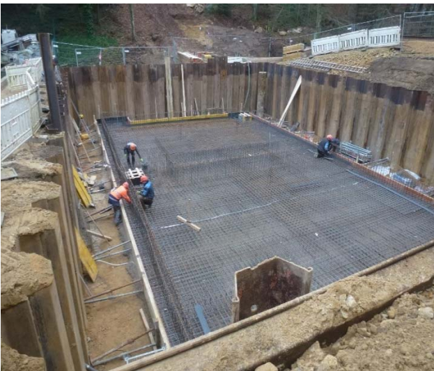
Photo: Ferrailage du radier du bâtiment technique de la station d'épuration de Consdorf
