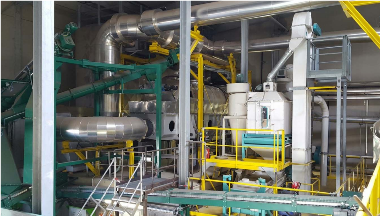
Fig 4 : Vue sur l'unité de granulation (au milieu) et le sécheur vibrant à lit fluidisé (à gauche).
