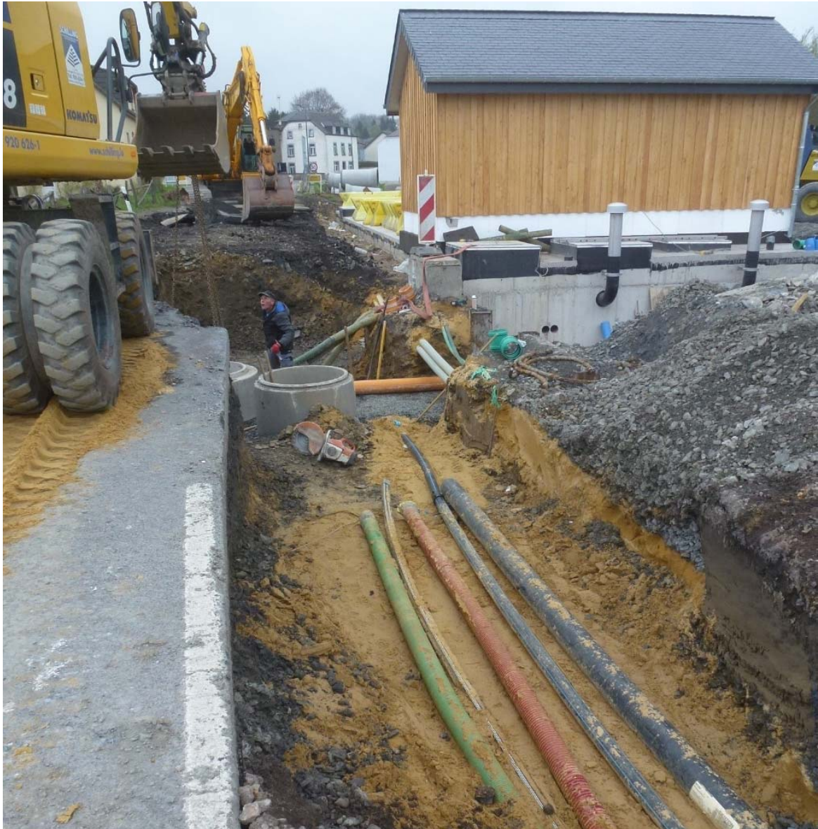
Photo: Bassin d'orage et station de pompage à Troine
