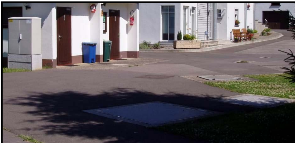
Siicht opt d'ënnerirdesch Pompelstatioun mat Schaltschaf vum Camping Tëntesmillen
