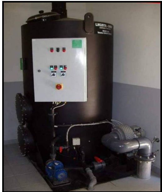
Oofloftfilter vun der Kläranlag
