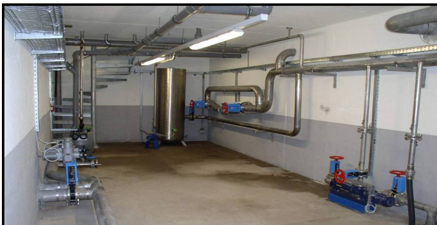
Siicht an den Keller vun der Kläranlag mat der Waasseropberéidungsanlag an de Schlammppumpelen
