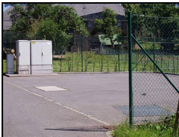
Kanalstauraum mat Schaltschiëf zu Kaalber
