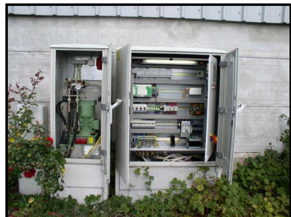
D'Schaltschiëf vum Kanalstauraum zu Hengischt
