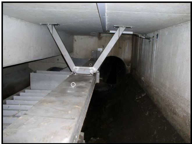
Feinréch am neien Kanalstauraum zu Hengischt
