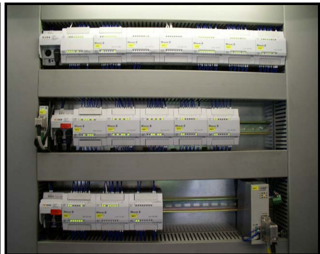
Computer(fern)steuerungsautomaten vun der Kläranlag
