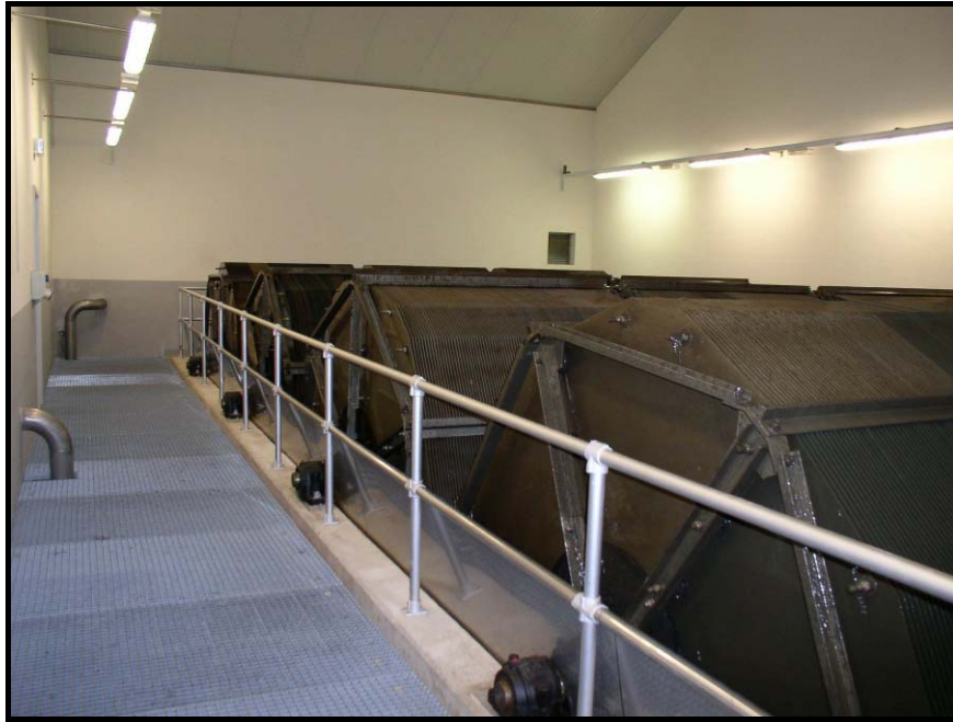
Siicht op déi dréiend Biodisken mat Bakterien an der Klärhal
