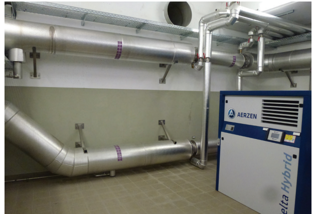
Geblüserraum und Wärmetaucher
