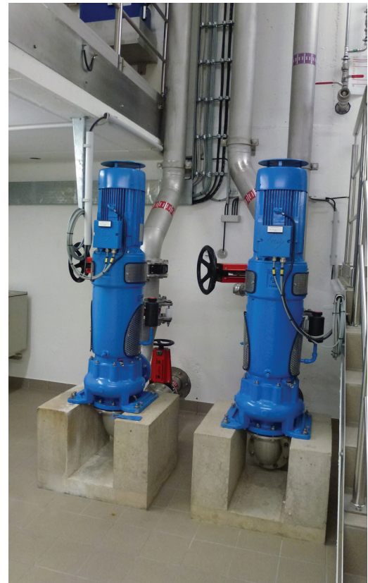
Entleerungspumpen RÜB Weidingen
