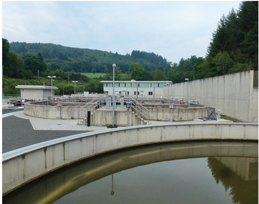
Nachklärbecken mit Sicht auf die Biologie und das Betriebsgebäude
