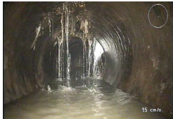
Undichter Kanal vor Sanierung
