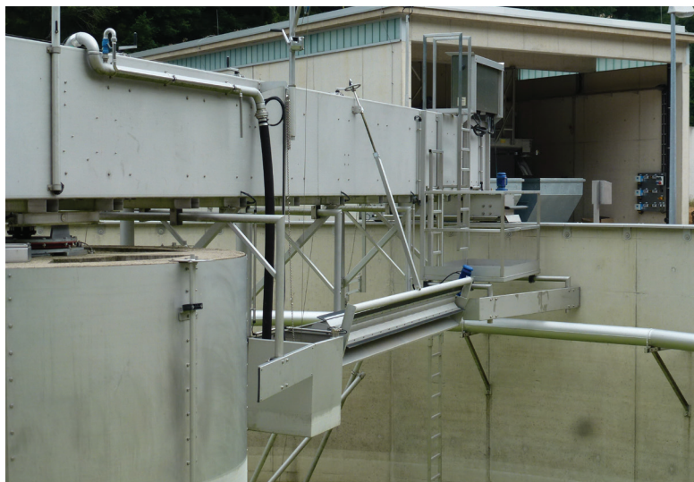
Räumerbrücke im Nachklärbecken mit Sicht auf das Schlammbehandlungsgebäude
