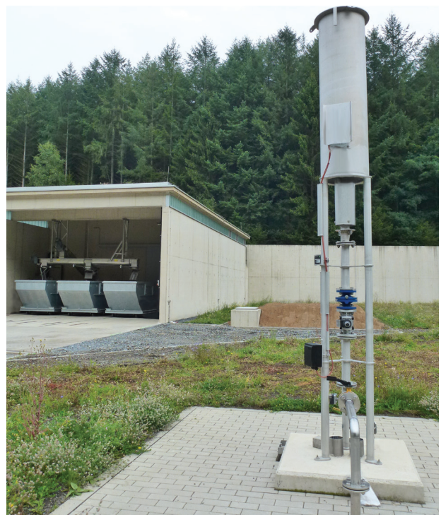
Gasfackel mit Biofilter im Hintergrund
