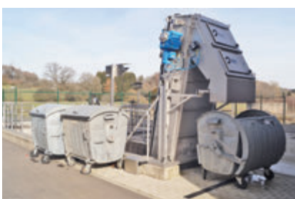
Grobrechen im Einlauf
