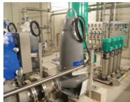
Zulaufpumpwerk und Brauchwasseranlage
