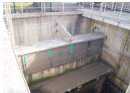
Feinsiebrechen am Entlastungsbauwerk des Stauraumkanals
