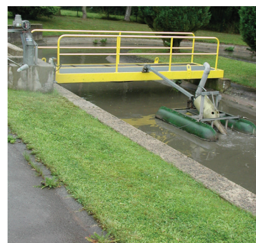
Aérateur du bassin biologique à Mertzig
