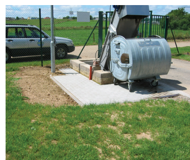
Dégrilleur à Grosbous
