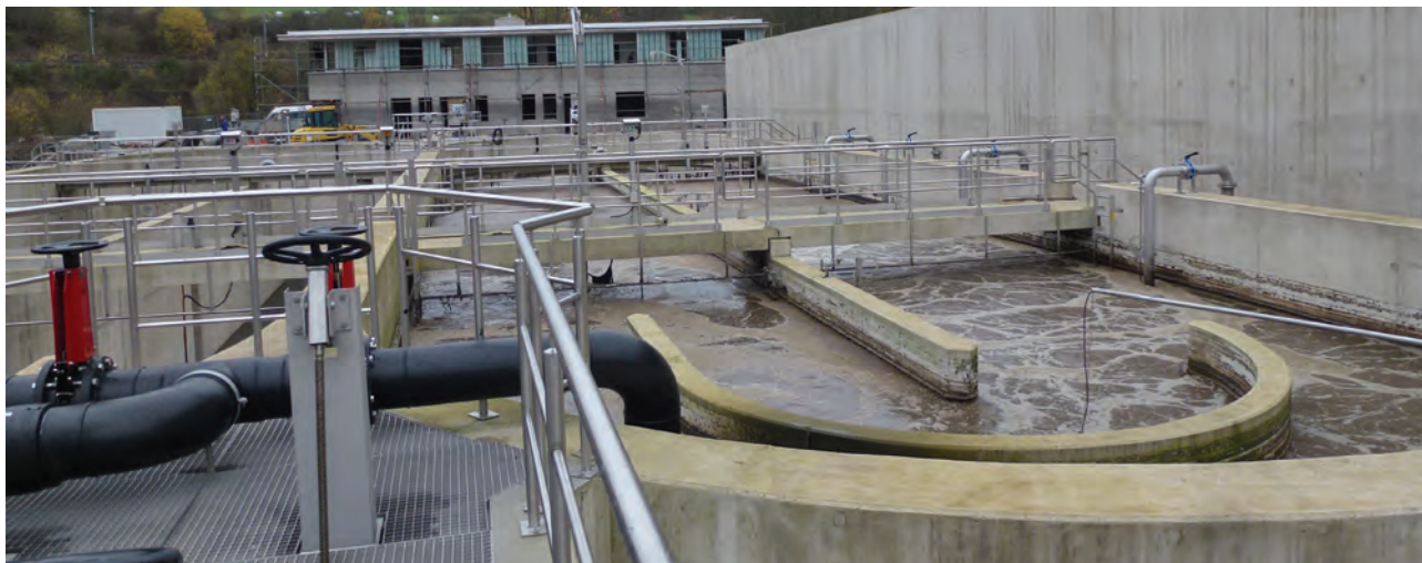
Bassin biologique (en service) avec vue sur le bâtiment de service / Belebungsbecken (in Betrieb) mit Blick auf das Betriebsgebäude
