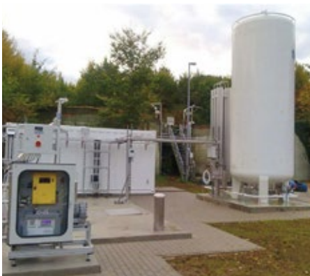
Exemple d'une unité de traitement quaternaire Beispiel einer 4. Reinigungsstufe
