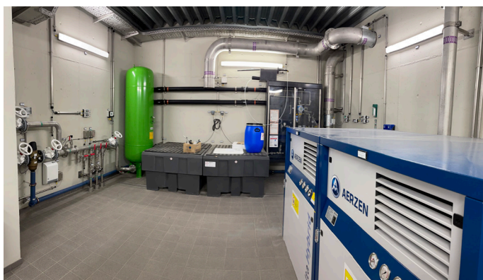
Salle des surpresseurs et installation de précipitation des phosphates
