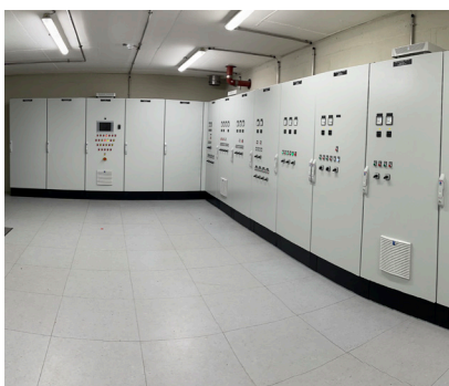
Vue sur les installations électriques
