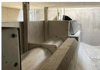
Équipement du seuil avec un dégrilleur fin
