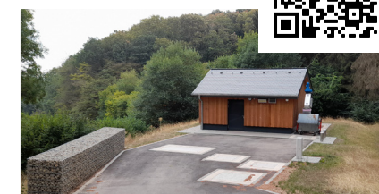
Bassin d'orage avec station de pompage de Kehmen
