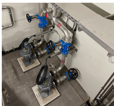
Station de pompage des boues en excès
