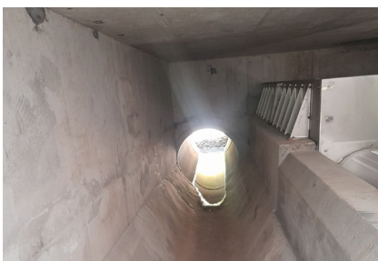
Intérieur du bassin d'orage de Michelau
